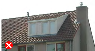
Niet passend door vorm (aangekapte dakkapel).
